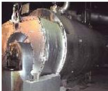
ボイラーの保温材
