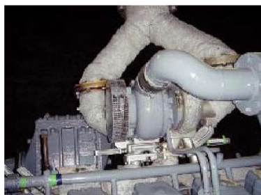
配管エルボの保温材②
