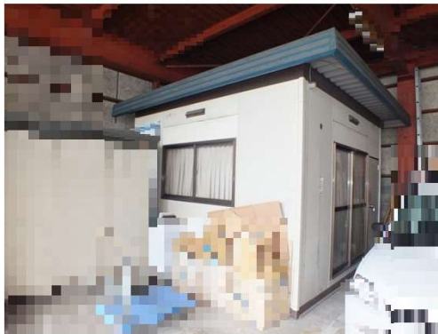
基礎が施工されていない非木造プレハブ建物
